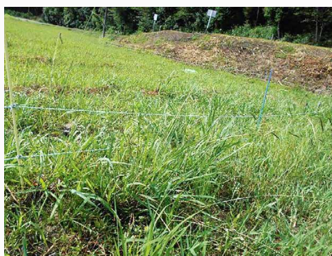
写真1 電気柵に接触する雑草 （漏電により電圧が低下する）
