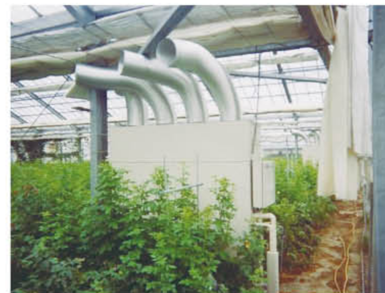
ヒートポンプ
